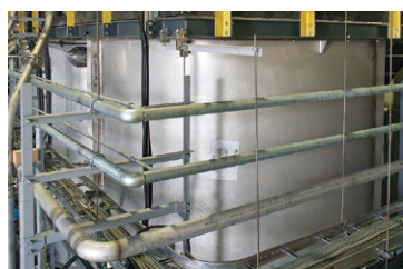
脱硫・中和槽
